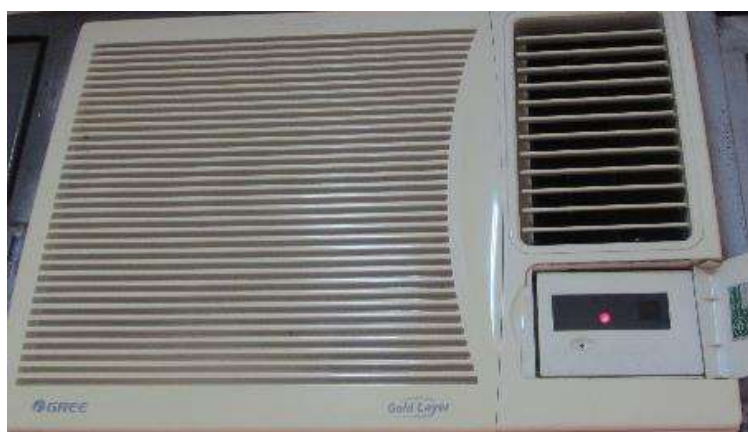
Figura 22 - AC 18000 btus - ADMINISTRAÇÃO CEASA MARINGÁ
