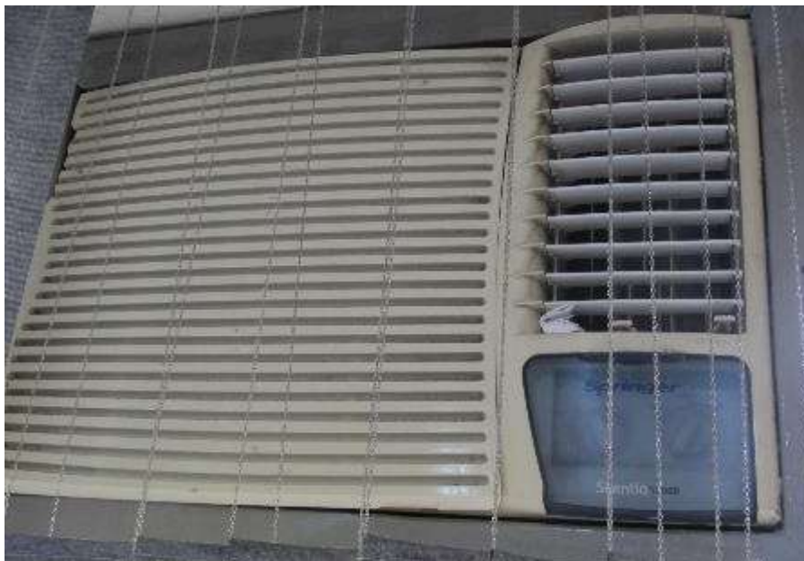
Figura 23 - AC 10000 btus - ADMINISTRAÇÃO CEASA MARINGÁ
