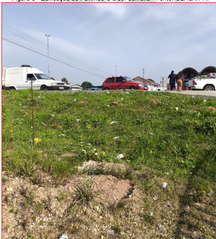
Figura 6 - Talude das Docas que deverá ser executado a drenagem e retaludamento - Fonte: CEASA/PR.
