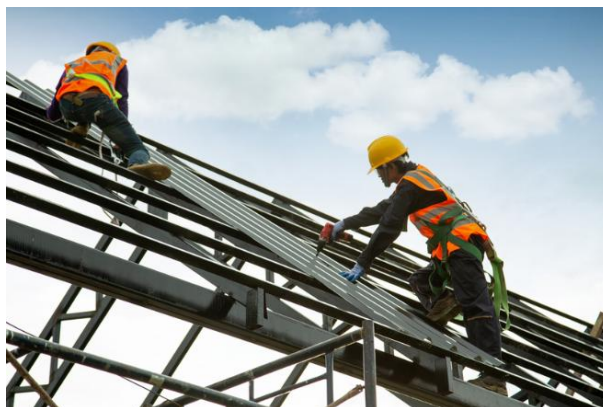
Figura 16 - Uso de cintos de segurança e trava quedas em estrutura de cobertura
